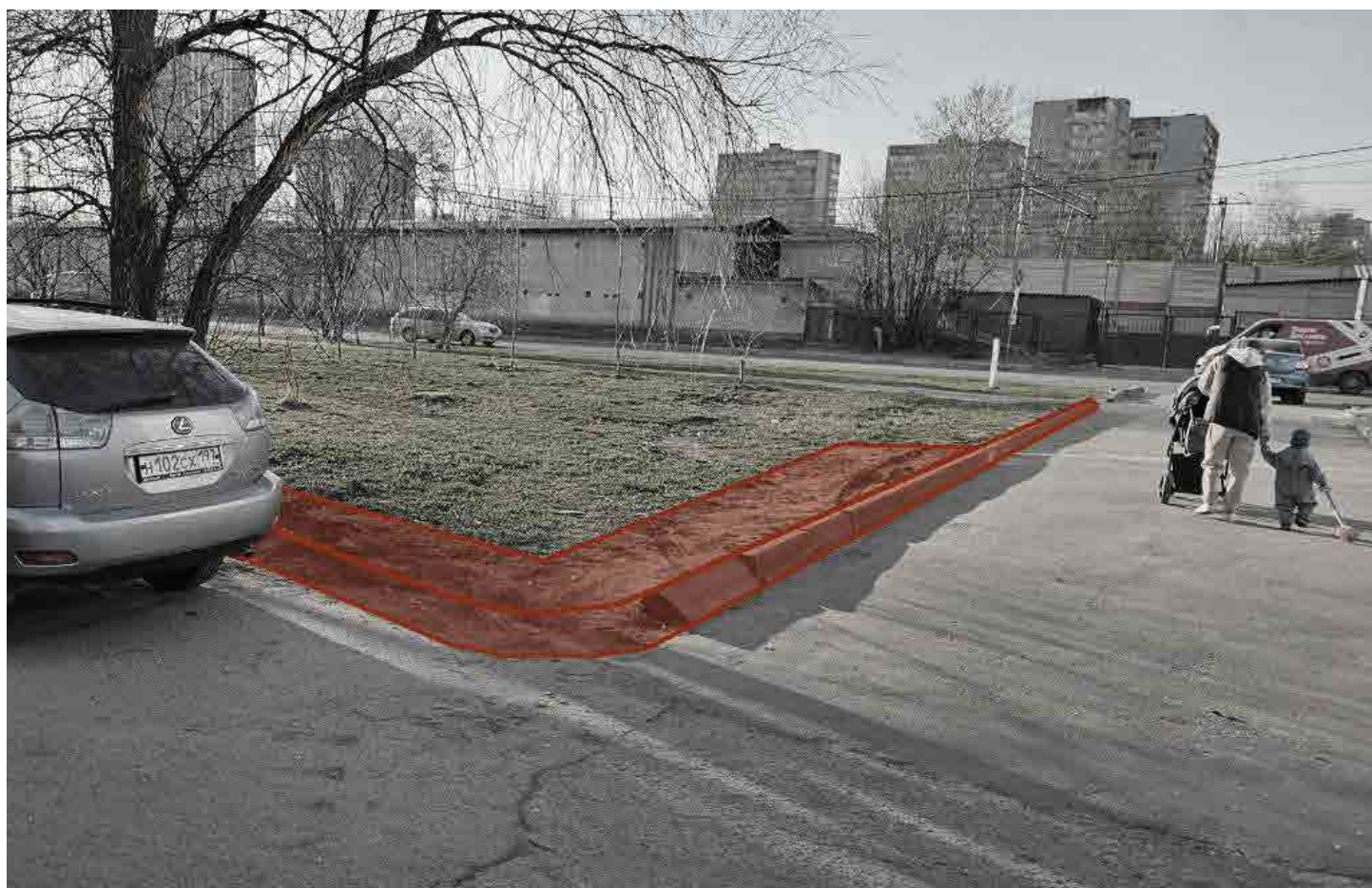
Отсутствует полноценное озеленение территории, изношены или отсутствуют дорожные бордюры
