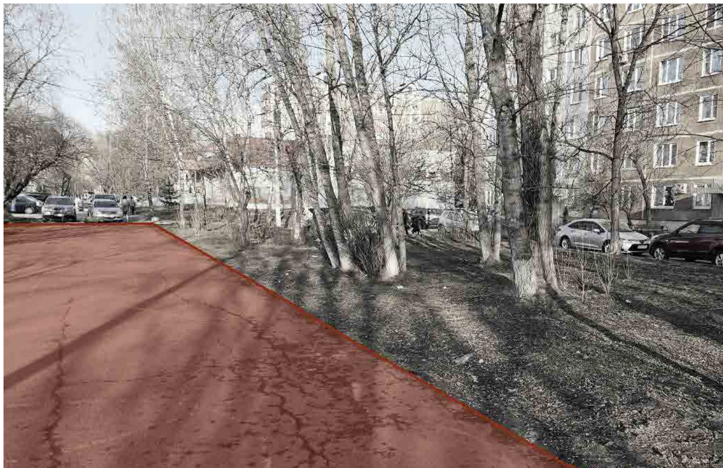
Изношенность покрытия, отсутствие благоустройства, нет равномерного озеленения вдоль аллеи, отсутствие садового бортового камня
