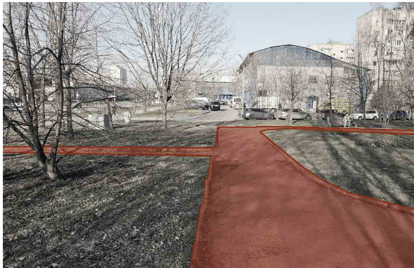
Изношенность покрытия, изношенность садового бортового камня, устаревшие элементы благоустройства
